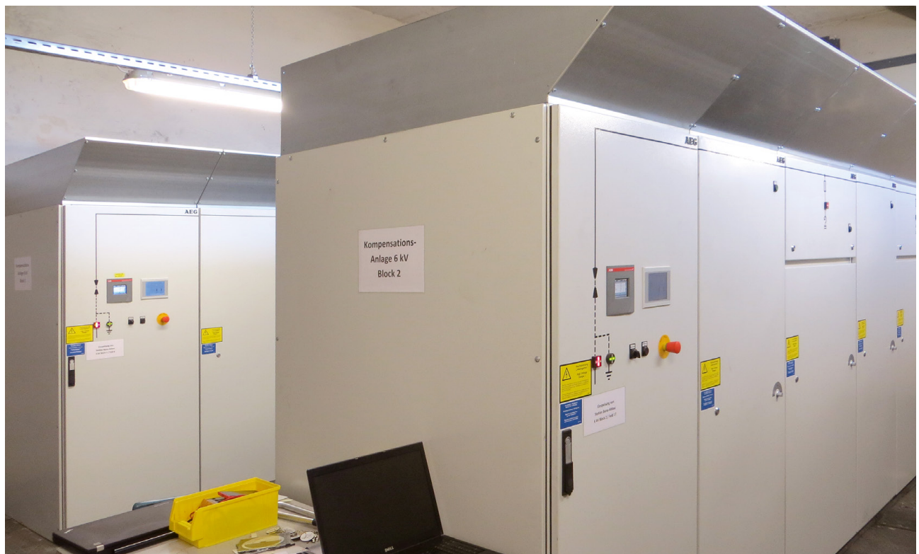
Störlichtbogengeprüfte Mittelspannungs-Kompensation 6 kV; 2 x 1.500 kVAr; P=7 %
